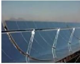
năng lượng mặt trời solar collector
