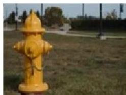
vòi nước máy Fire hydrant
